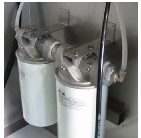
Allestimento: Sistema di filtraggio
